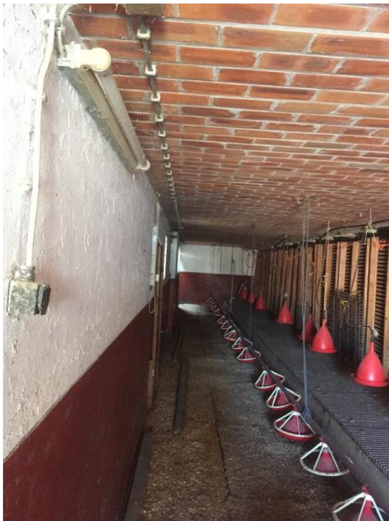
Foto 37. Tegels aan onderzijde vlak plafond.
