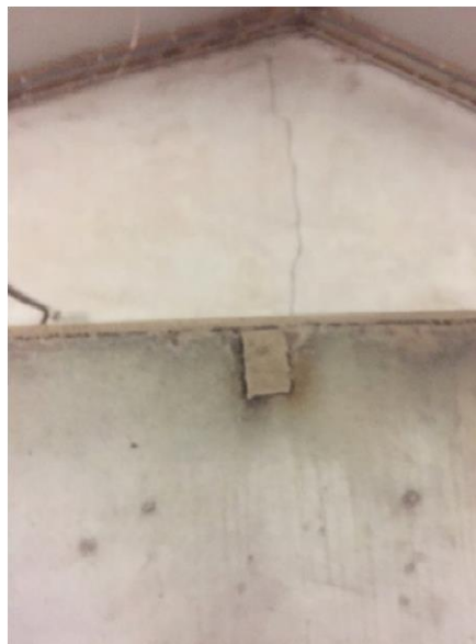
Foto 8. Scheur in de scheidingswand.
