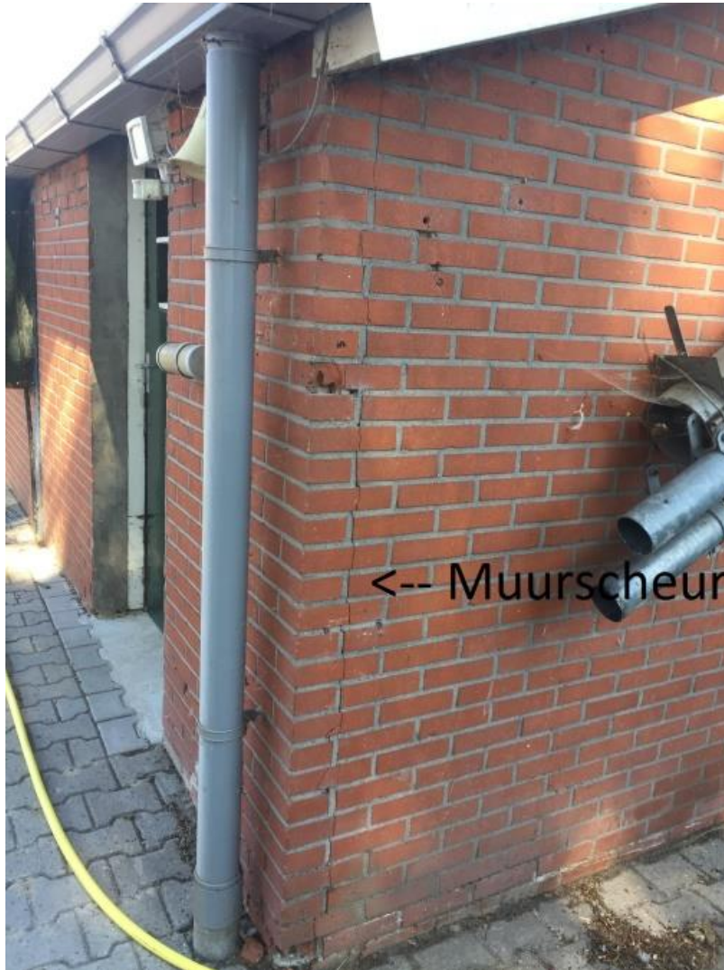
Foto 3. Scheur in de voorgevel van stal 1.
