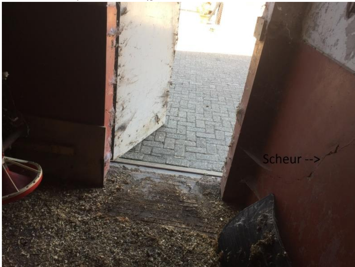
Foto 38. Scheur in afdelingswand gebouw B.
